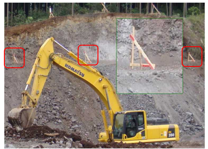
丁張りを目安に掘削位置をオペレータが判断し建設機械を操作
